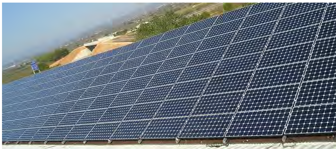
Ejemplo de una instalación finalizada
